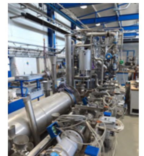
Banc avec échelle couvrant les faibles débits
